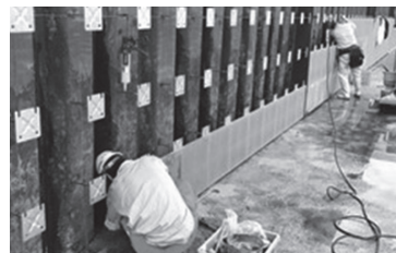
農林水産大臣賞 パネル被覆工法「ストバネ工法」による腐食鋼板水路の補修・迅速再生技術の開発 藤村クレスト株式会社
